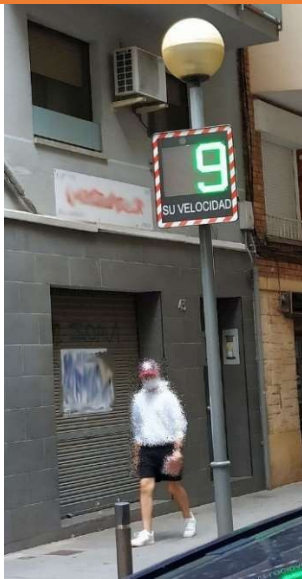
Instalación Radar en farola:
