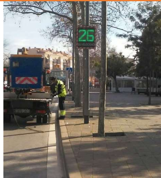
Instalación en farola:
